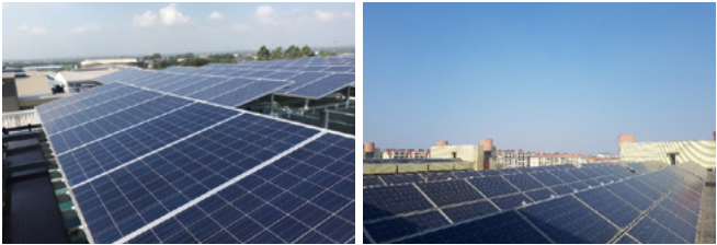
▲ 베트남법인 태양광 발전 설비 ▲ 중국법인 태양광 발전 설비
